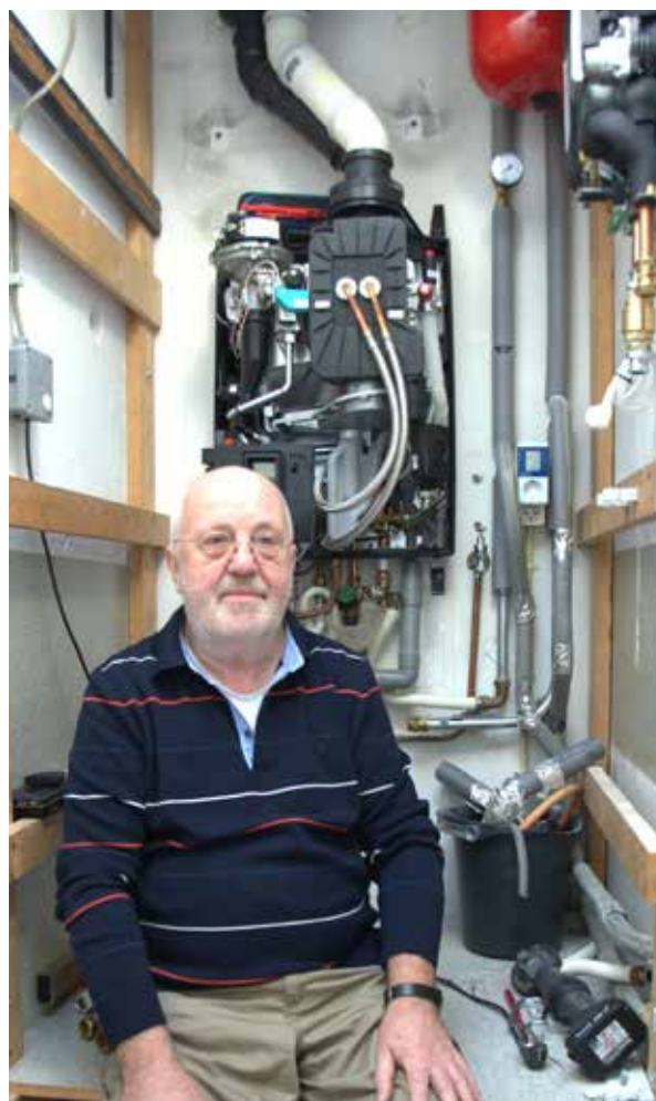
Hans Gielen zit tevreden voor de warmtepomp die in zijn huis wordt geïnstalleerd
