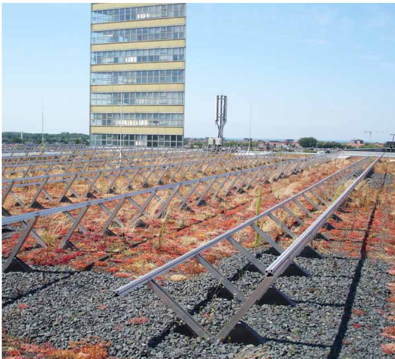
Opbouw voor zonnepanelen op dak World Forum
